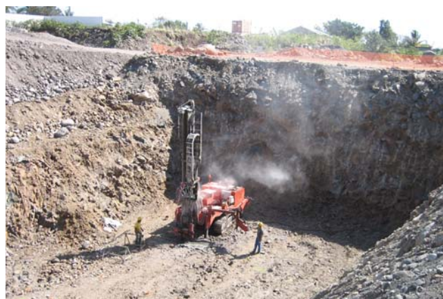
Prédécoupage et minage au droit des barrettes de la Pile P1 - Côté rive gauche
