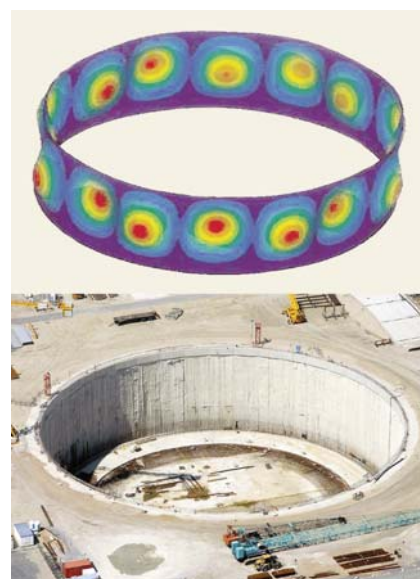
Etude tridimensionnelle des déplacements pendant le flambement sur la paroi moulée
