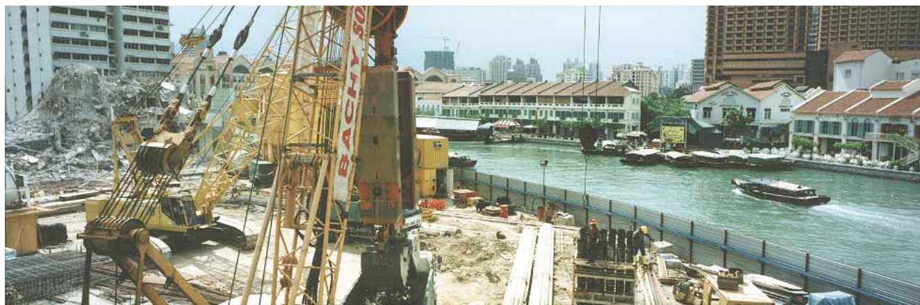
Zone de paroi en cours d'excavation le long de la rivière Singapour
