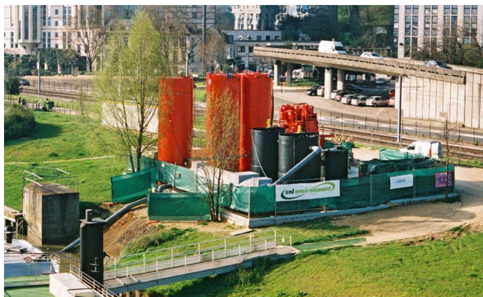
Station de traitement provisoire
