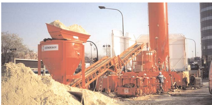
Centrale automatisée de fabrication de mortier
