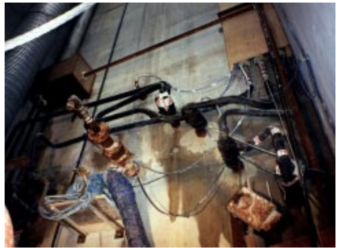
Rampe de distribution de l'azote liquide
